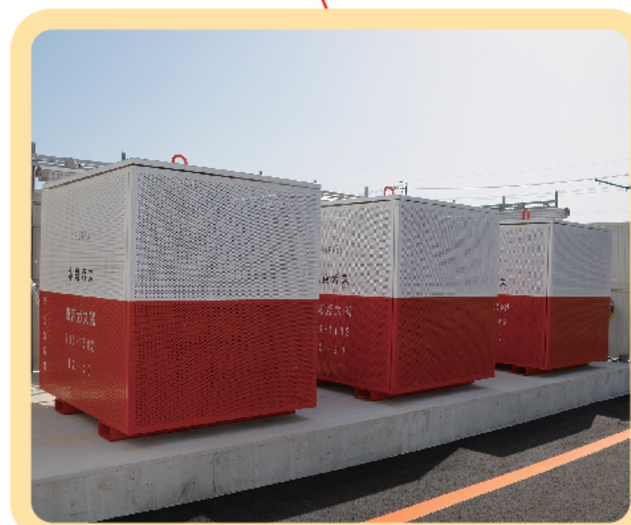
水素カードル (車両衝突防止)
